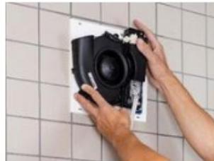
Enclipsage du ventilateur
